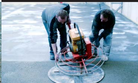
4 Nach dem Einstreuen der Hartstoffe werden diese mittels Glättmaschine in die noch frische Oberfläche eingeglättet
